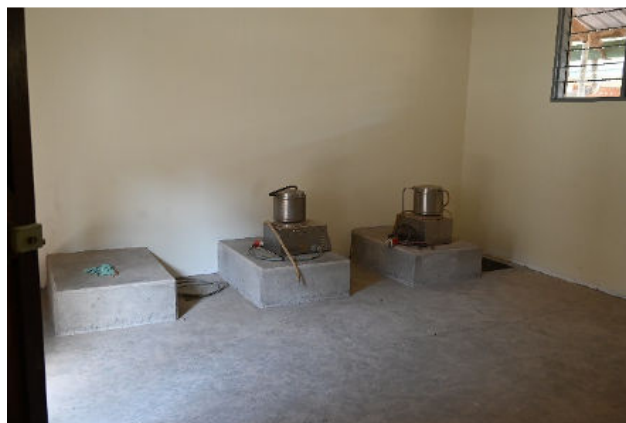
Nuova sala dell'autoclave
